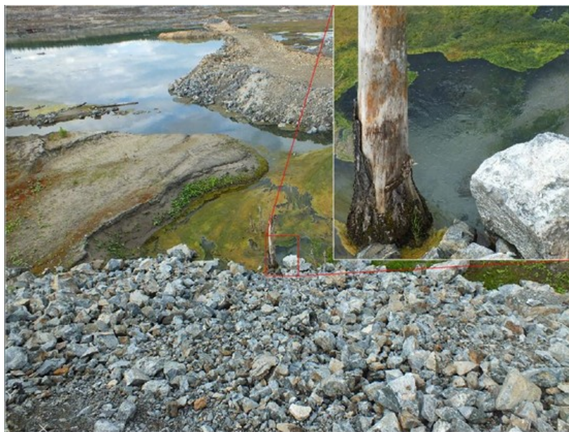
Рис. 5.21. Фонтанирование воды у основания сооружения
