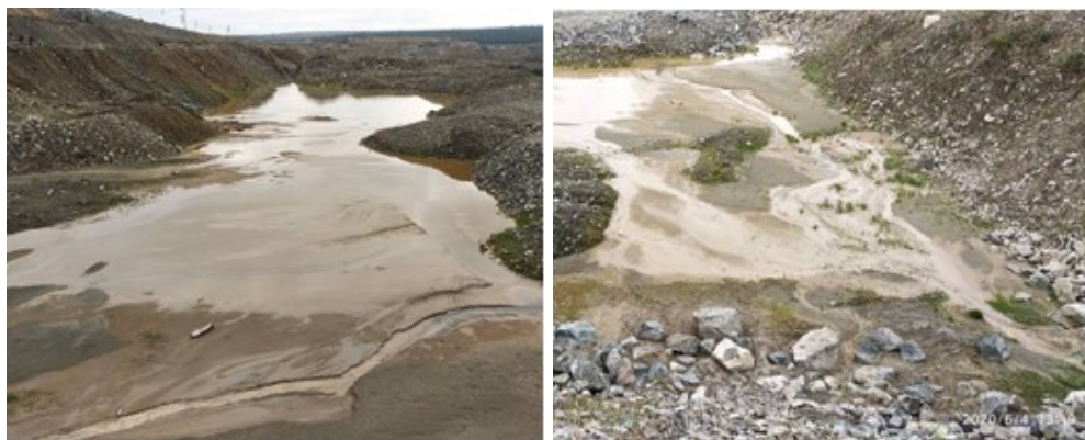
Рис. 5.12. Следы суффозионного выноса материала насыпного ГТС
