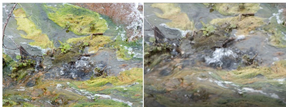
Рис. 5.29. Фонтанирование воды у основания дамбы
