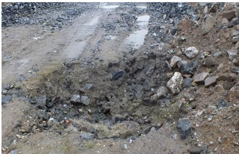
Рис. 5.16. Локальная деформация поверхности полки ГТС
